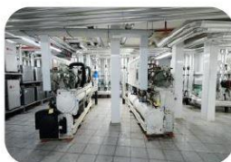
2. Equipos de producción mediante energía geotérmica
