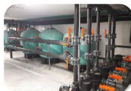
3. Sala de Máquinas Piscinas
