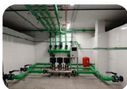
6. Sala de Hidrocompresor con variadores de velocidad
