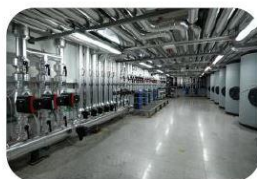
1. Sala de Máquinas Térmica
