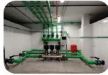
6. Raum mit Hydrokompressor mit variabler Geschwindigkeit
