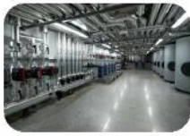
1. Raum mit Wärgekraftmaschinen
